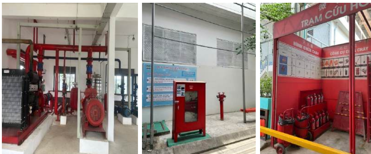
Hình 30. Trang bị PCCC của nhà máy
