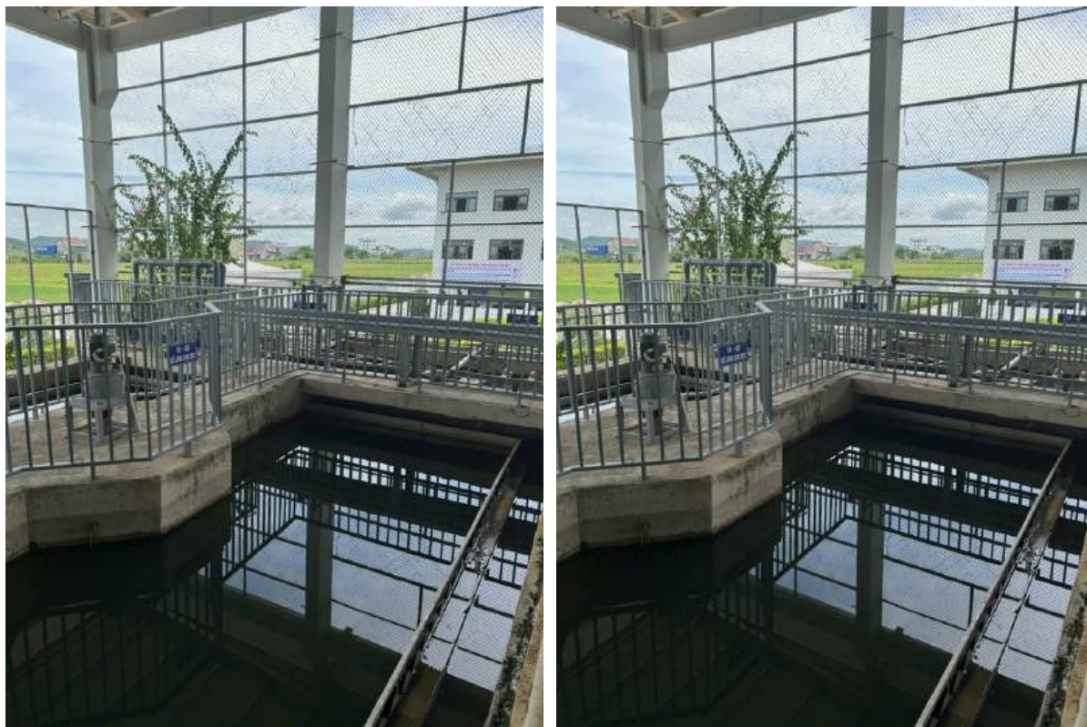
Hình 15. Hình ảnh của hệ thống xử lý nước thải tập trung
