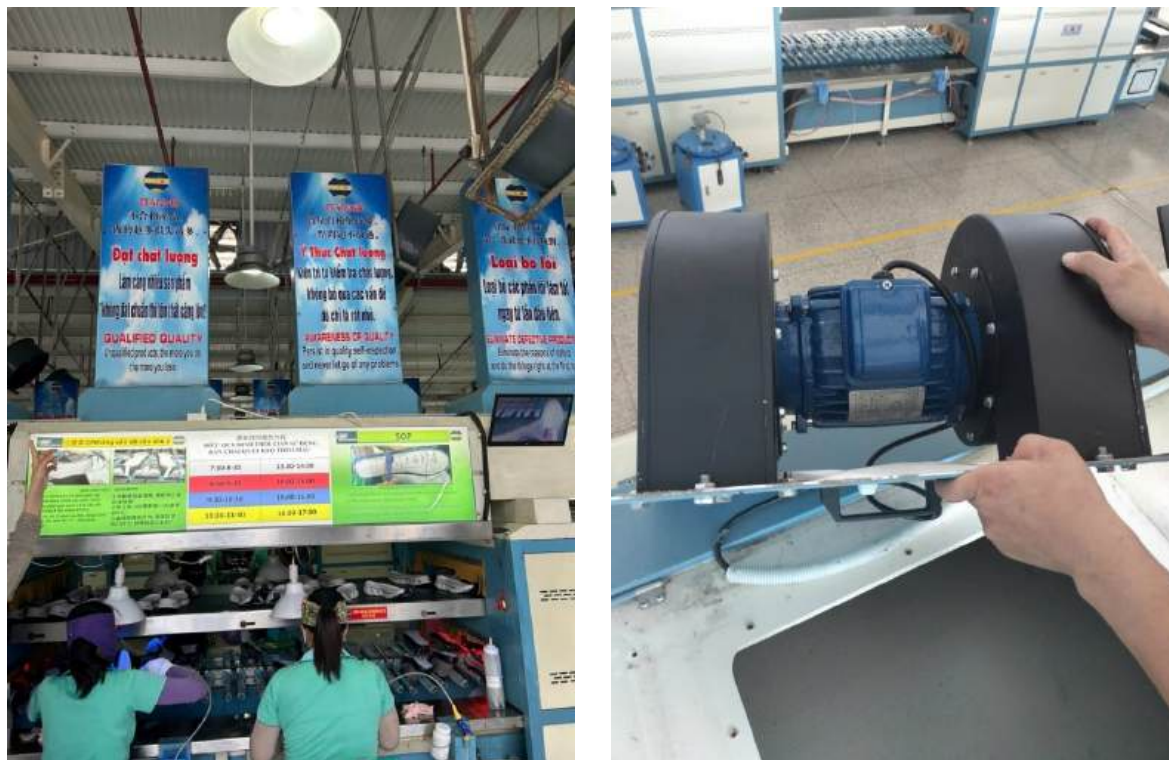
Hình 21. Hình ảnh thiết bị xử lý khí thải bằng than hoạt tính tại chuyền hoàn chỉnh
