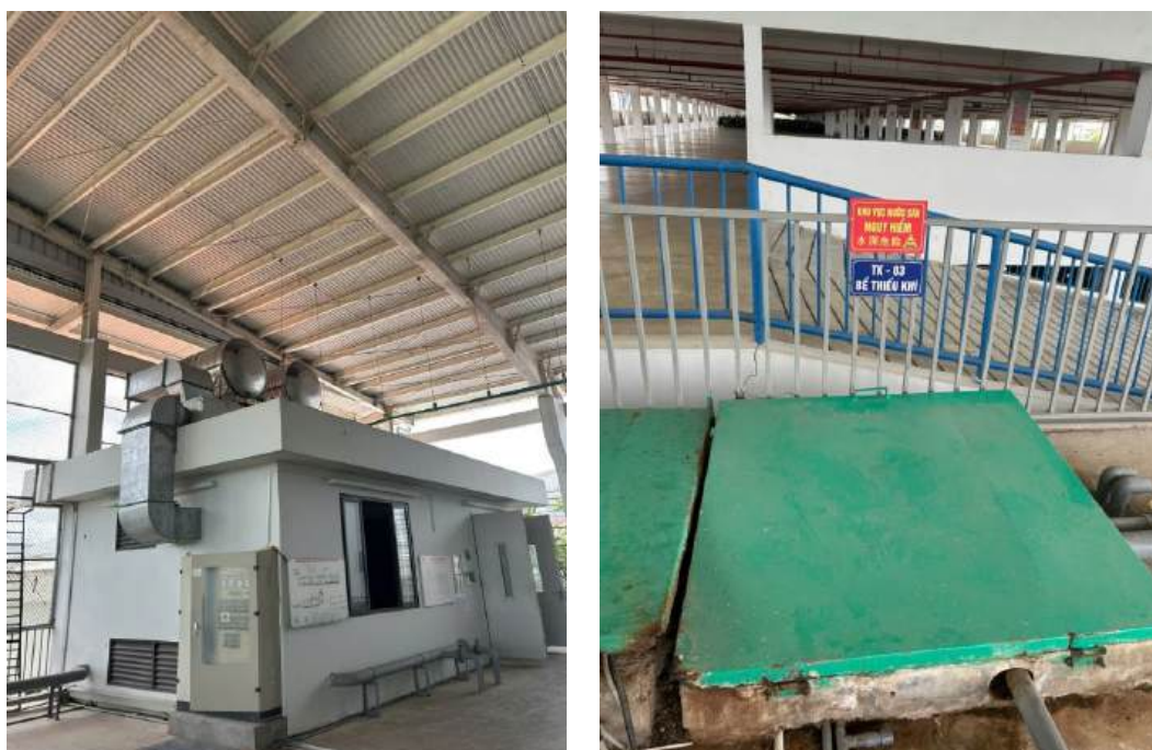
Hình 26. Hình ảnh biện pháp giảm thiểu tác động mùi hôi từ HTXLNT tập trung g) Biện pháp giảm thiểu mùi từ hoạt động của nhà bếp
